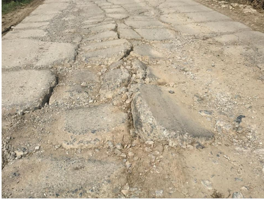
图3-1 矿区周边乡道冻土冻融导致路面破损
